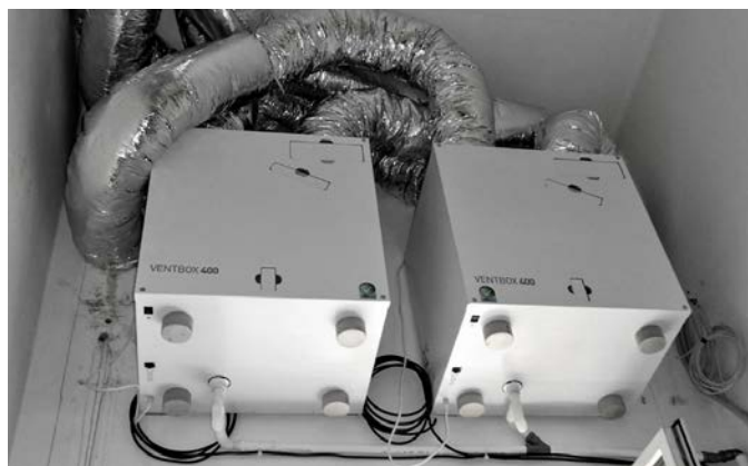
Dvě rekuperační jednotky a část rozvodů (VENTBOX 400)
